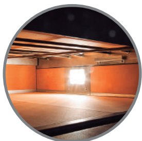
Cámara, ladrillos refractarios
